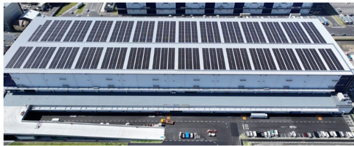
【「ロジポート名古屋 2」に設置された「DREAM Solar 愛知岩塚」】
