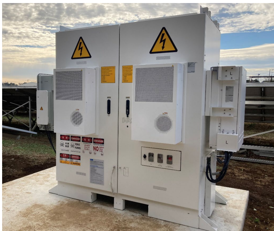
写真 新設した蓄電池
