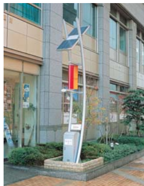
オフィスビル 外灯用電源
